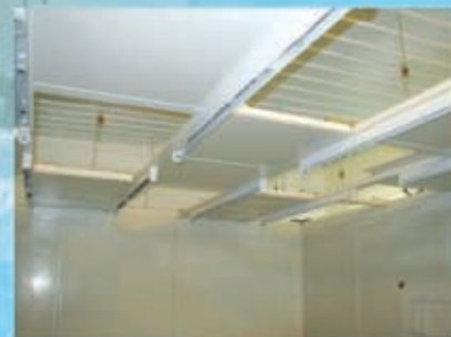
Подвесной модульный потолок (на основе несущего алюминиевого профиля) для чистых производственных помещений.
