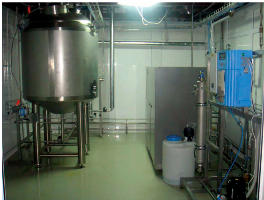
Рис. 6. Система приготовления, хранения и распределения воды для инъекций/воды высокоочищенной с использованием установки Septron line 30 HPW. ОАО Биохимик, Саранск
